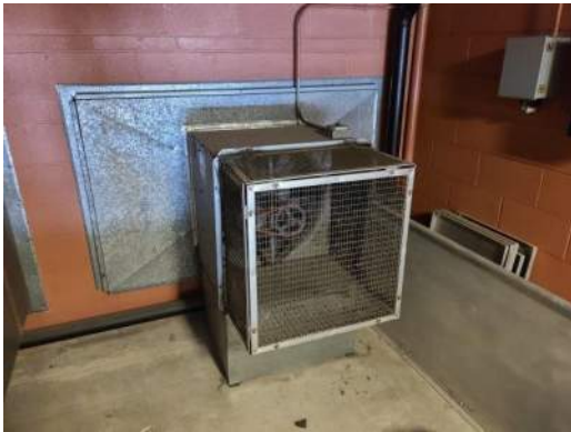
Apparatus Ventilation Exhaust Fan
