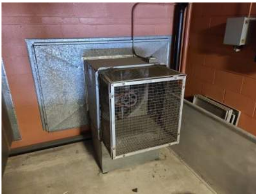
Apparatus Ventilation Exhaust Fan
